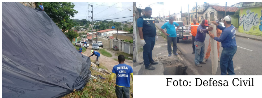
Foto: Defesa Civil
