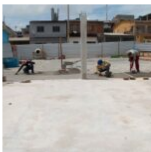
O prazo para finalização da obra é até o mês maio - Foto: Sandro Barros / PMO
